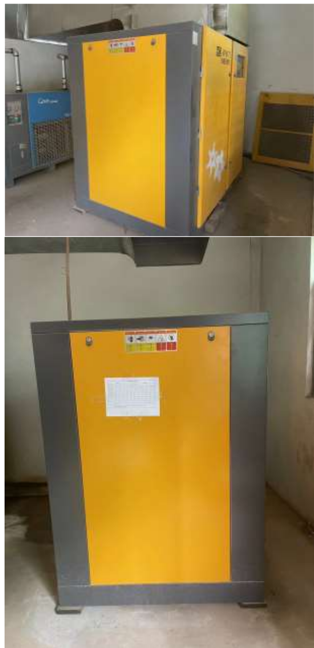
2 台 75kW 永磁電機及變頻的空氣壓縮機
